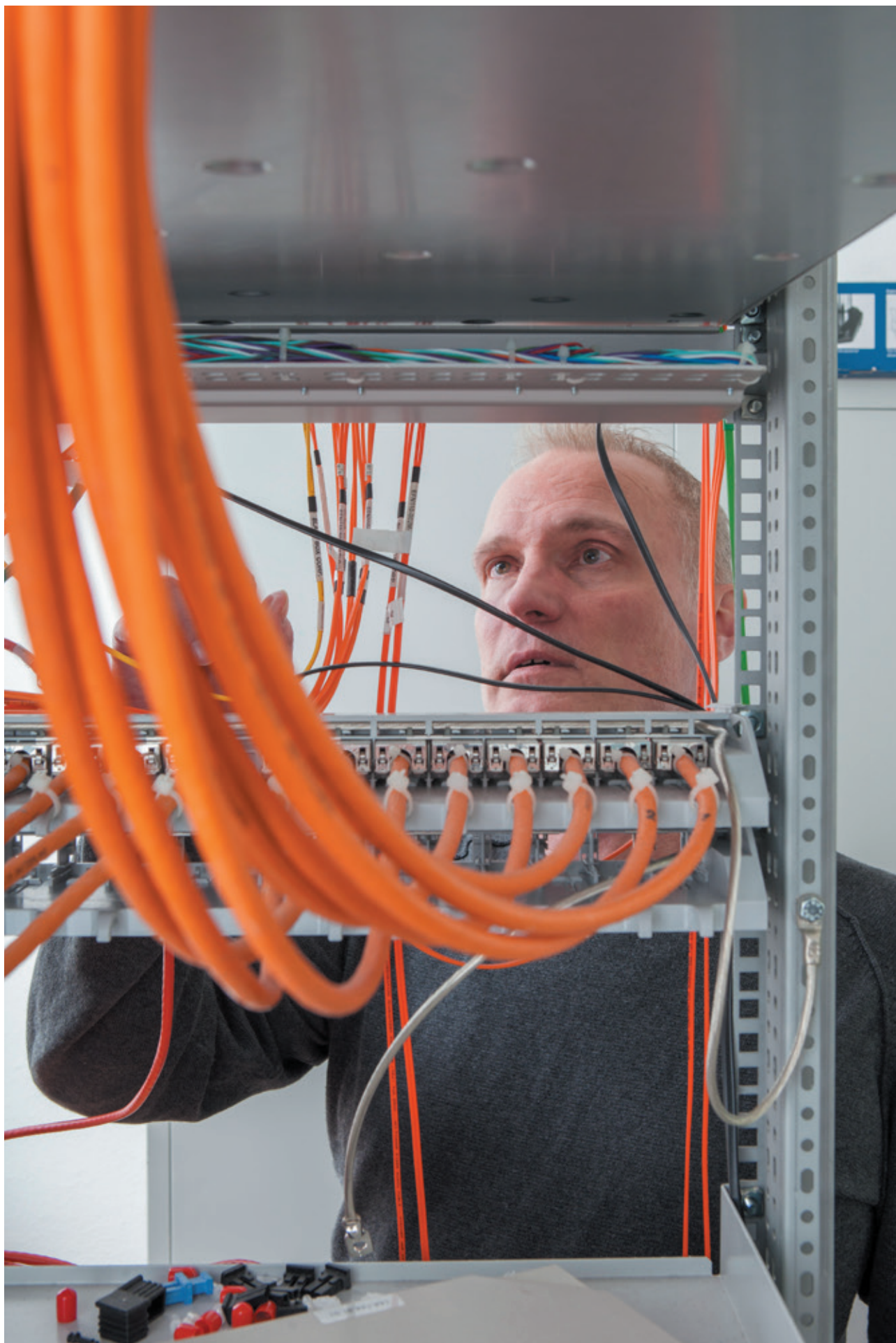
Dejan Trifunovic überprüft einen Netzwerkknotenpunkt am Kantonsspital. Die Mitarbeitenden der Informatik sorgen für eine funktionierende IT-Infrastruktur an allen Standorten der Spitäler Schaffhausen.
